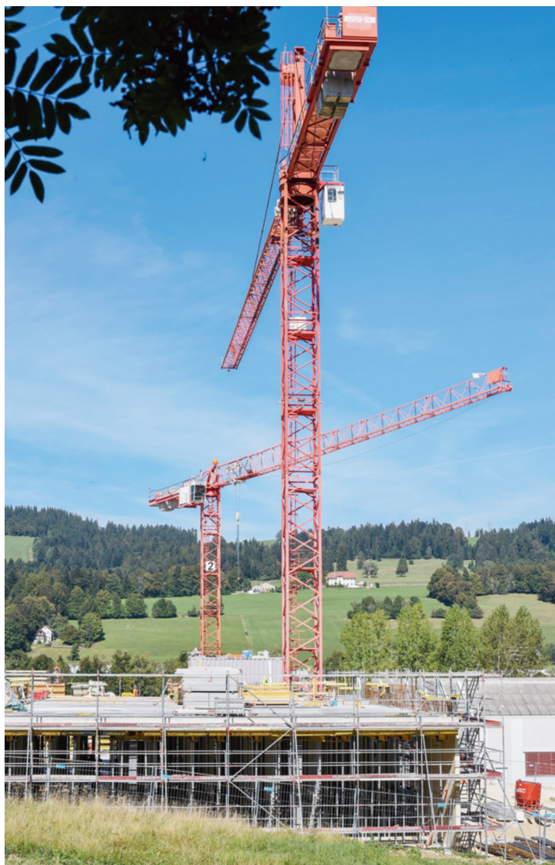
A deux pas du giratoire de la Combe-à-l'Ours, sort de terre le gros bâtiment industriel qui sera géré par la société Les Industriels des Sentiers, emmenée par Raffaello Radicchi. CHRISTIAN GALLEY
